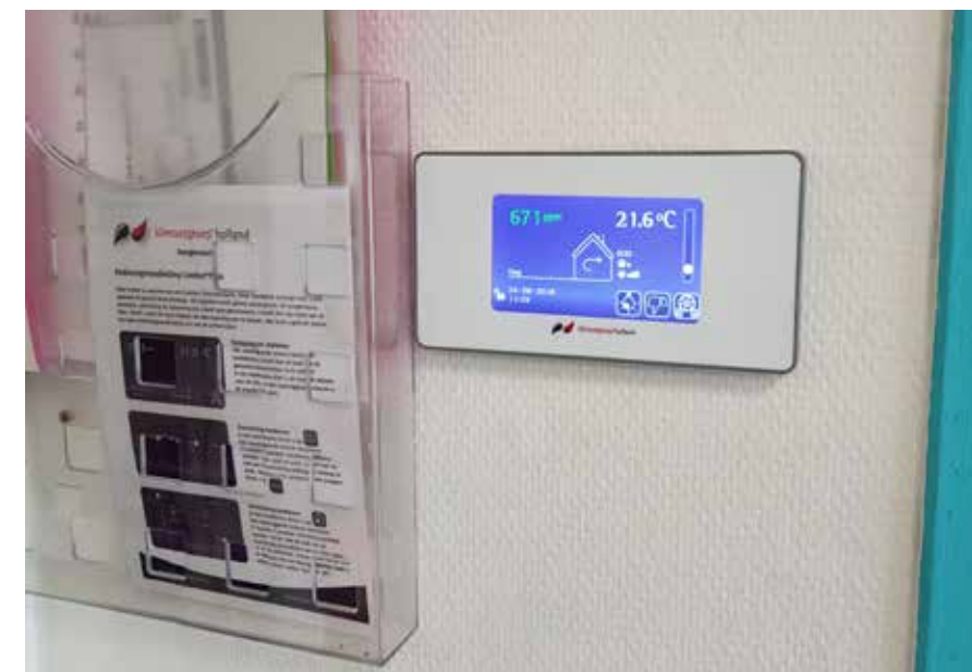
De klimaatunits zijn eenvoudig te bedienen middels een wand-bedienpaneel, waarin ook de sturing van de verlichting en zonwering geïntegreerd kan worden.
