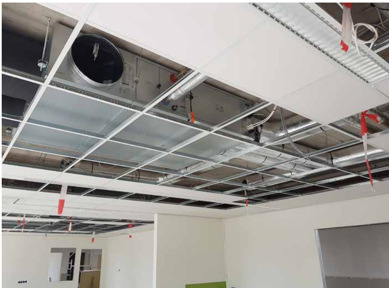
In 43 van de 47 lokalen zijn de nieuwe klimaatunits boven de verlaagde plafonds geïnstalleerd.
